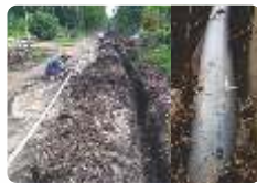
Trilliumpro @Proyek PAMSIMAS (Kalteng)
